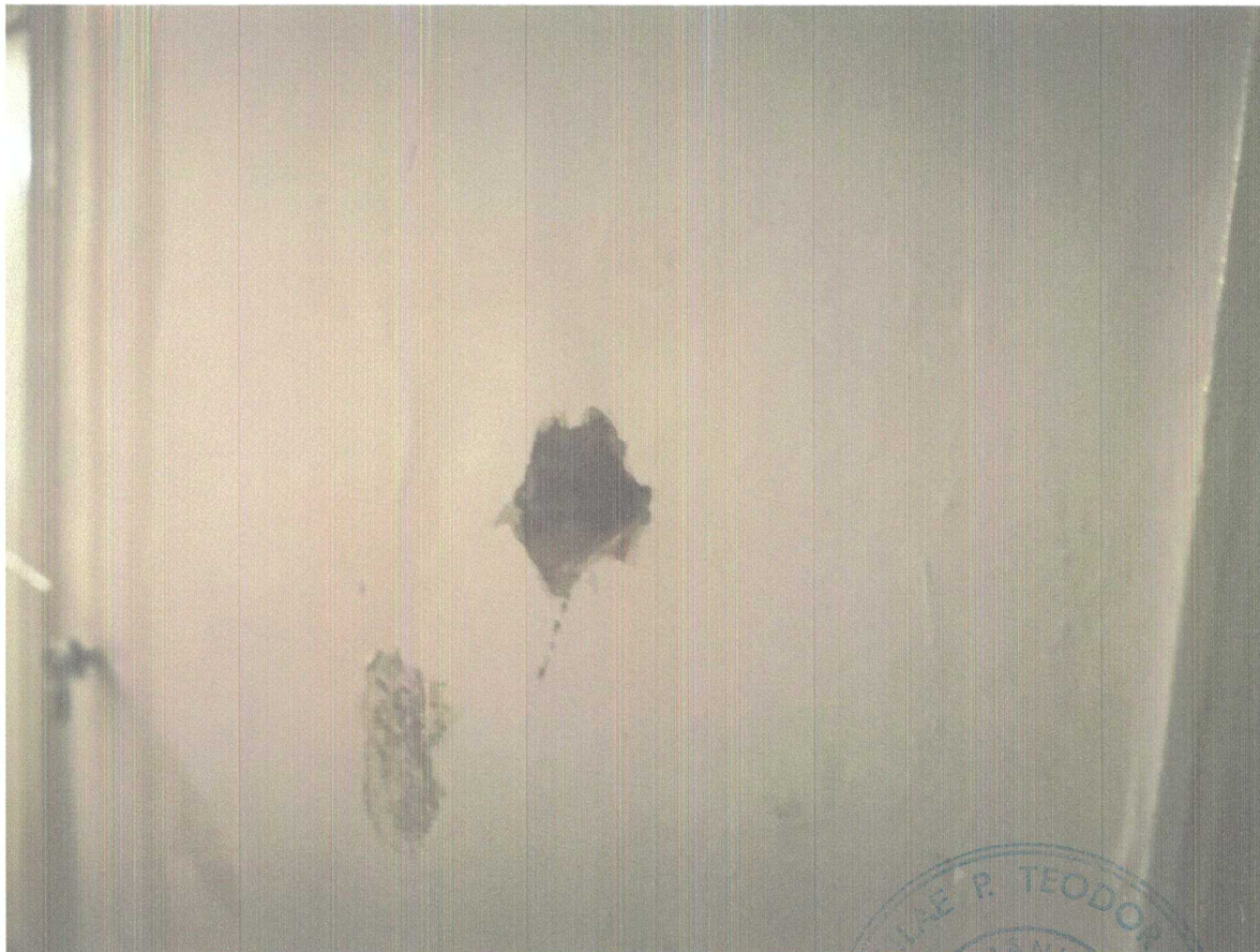
Decopertare strat de acoperire cu beton a armaturii peretelui din beton armat, culoar central.
