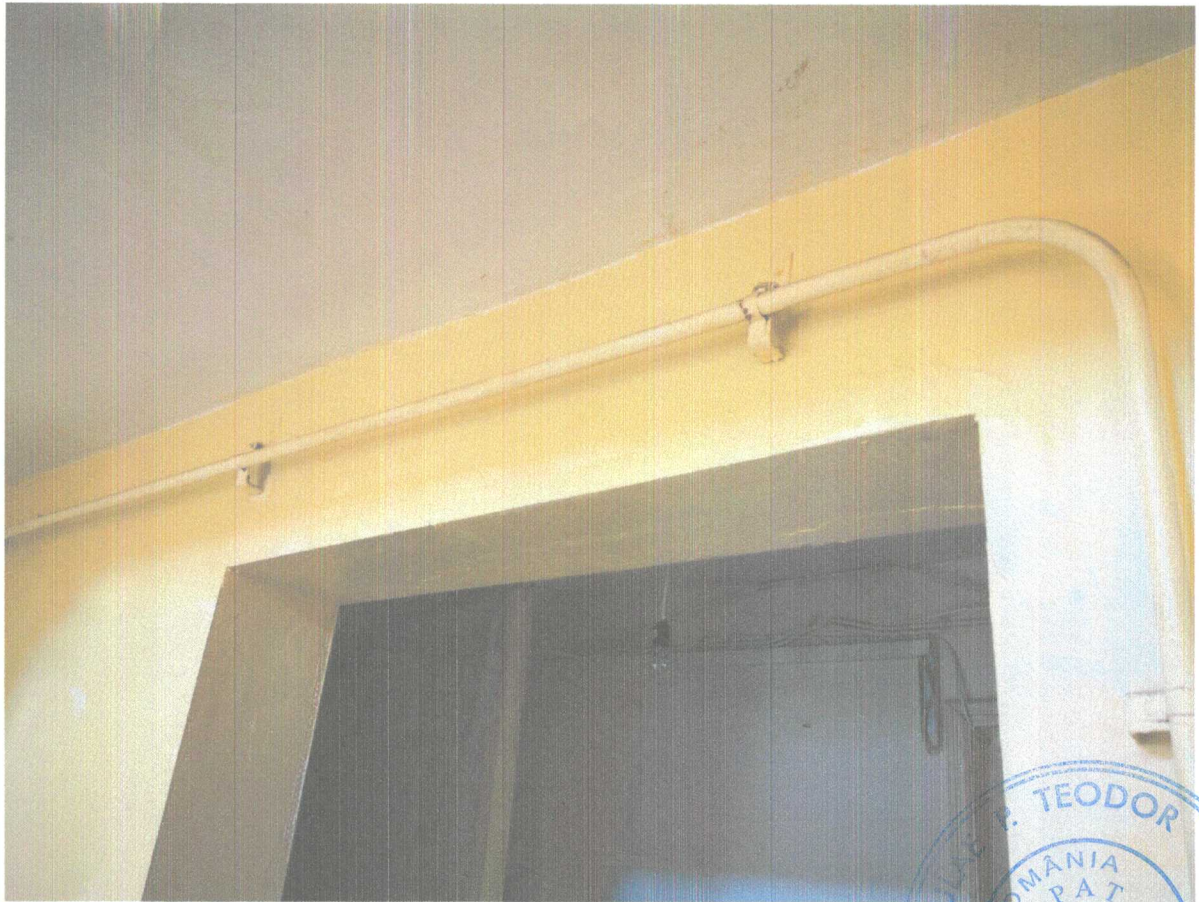
Grinda peste gol de intrare in culoarul central, din casa scarii. Structura de rezistenta nu prezinta degradari. Finisaje inechite.
