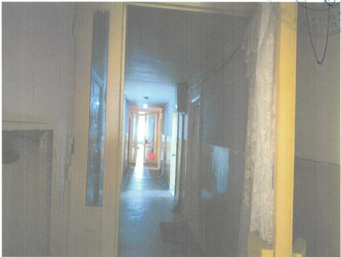
Culoar central. Peretii din beton armat nu prezinta degradari. Tamplarii si finisaje inechite
