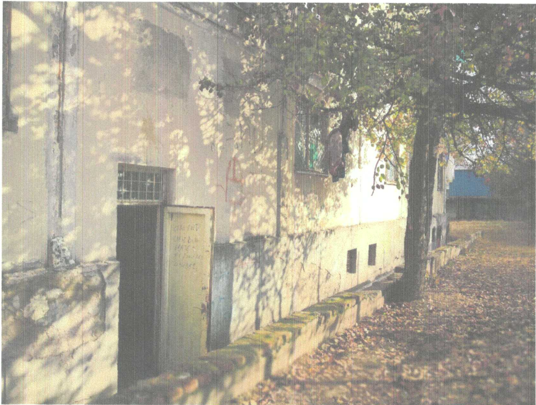
Rost între panouri, tamplarie și soclu – elemente nestructurale degradate. Prin infiltrarea apelor și înghețul acestora elementele nestructurale se pot prăbuși, și se poate afecta structura de rezistență prin acțiunea factorilor de mediu asupra ei
