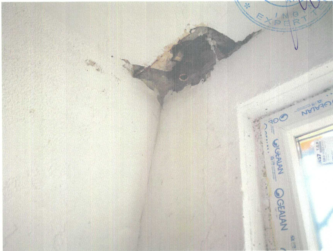
Gol practicat in placa din beton armat. Instalatii dezafectate, invecchite. Armatura este expusa ( \Phi 8 mm/20cm)
