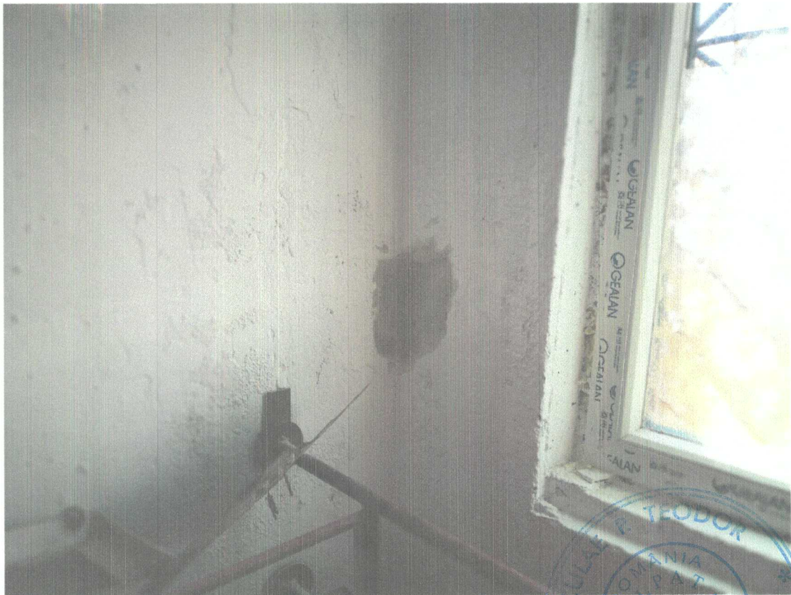
Perete transversal si de fatada, din beton armat. Decopertari ale tencuiei si stratului de huma
